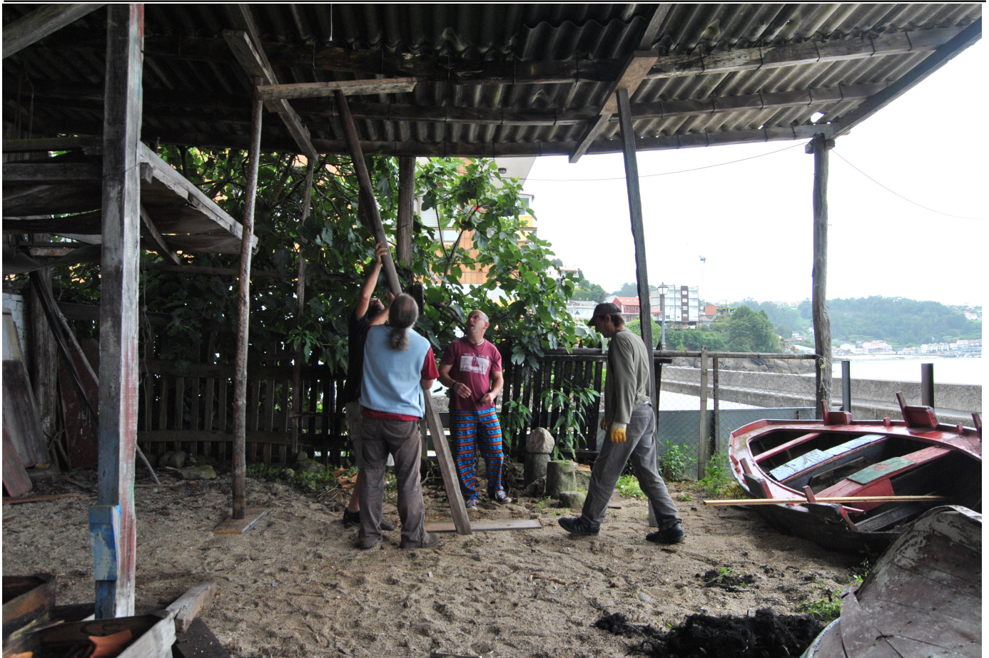
Varios membros da asociación apuntalan as partes máis danadas do tellado con remos e mastros.// D. B.
