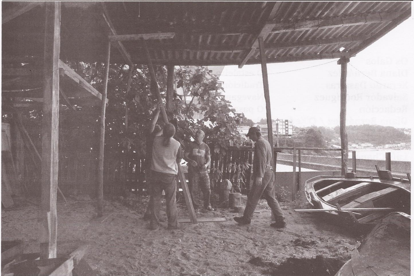
Varios membros da asociación apuntalan as partes máis danadas do tellado con remos e mastros.// D. B.
