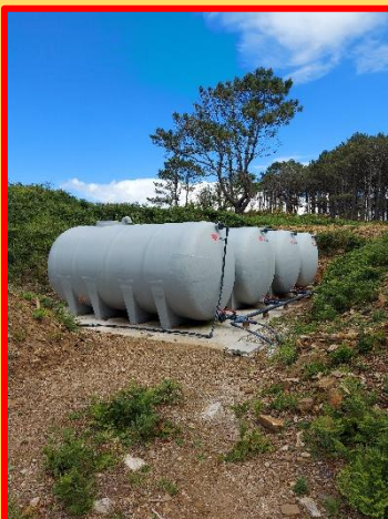
Depósitos de Chan que abastecerán, en caso de necesidade, ao barrio de Curro. A auga procede da fonte de Caniveliñas.
