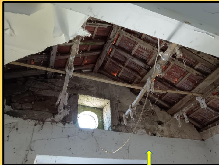
Estado da cuberta interior, mesmo enriba da porta.
