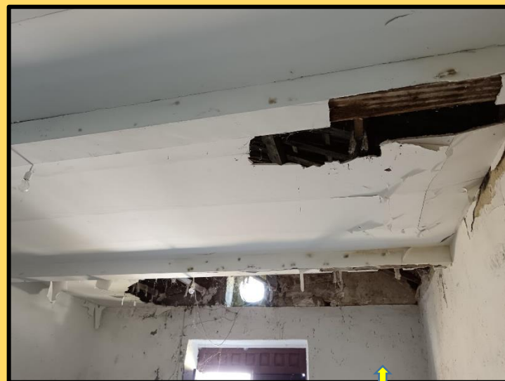
O deterioro do teito é evidente debido á humidade.
