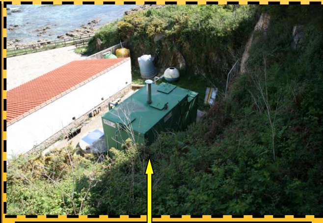
Primeira depuradora instalada. Foto ano 2011.
