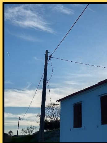
Foto do centro , os fortes ventos que nos últimos anos nos ofrecen as danas, provocan que moitos dos cables do tendido eléctrico sufran danos que causan graves cortes de luz.
