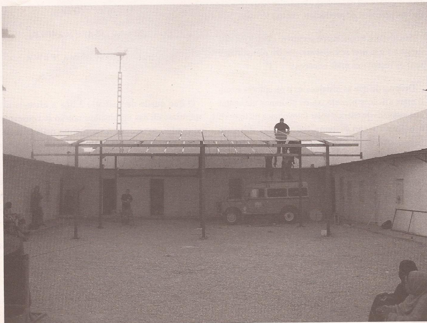
Foto dunha instalación feita no campamento de refuxiados no SAHARA, denominado Smara, para a alimentación dun hospital.
