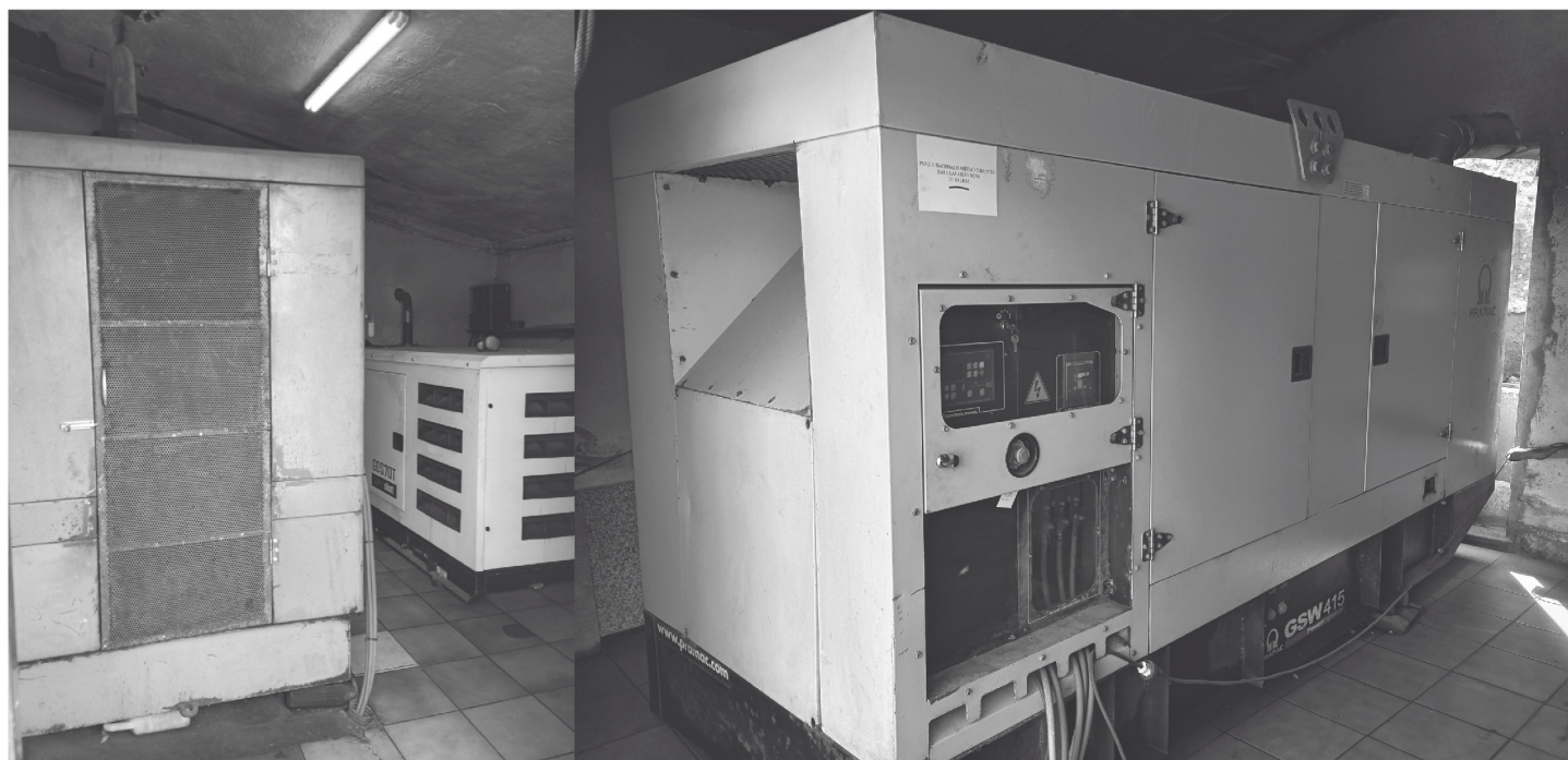
Actuais xeradores eléctricos. (Fotos do autor).
